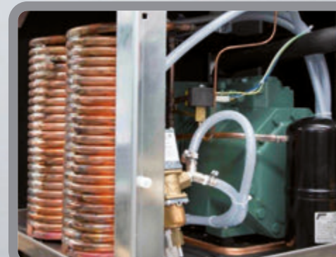
Condensazione acqua. Water cooling.
